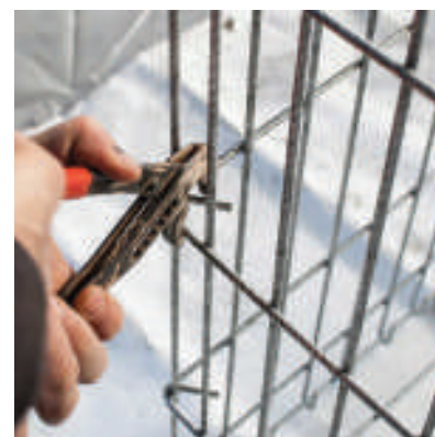
Foto 3 - Particolare chiusura ganci
